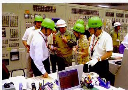
中部電力（株）四日市火力発電所の制御室にて
