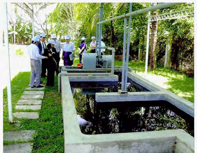
— 農業工場の廃水処理設備 —
