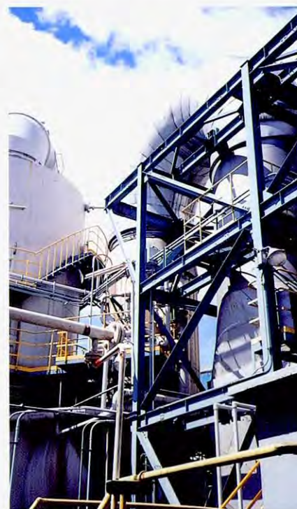
排煙脱硫装置
