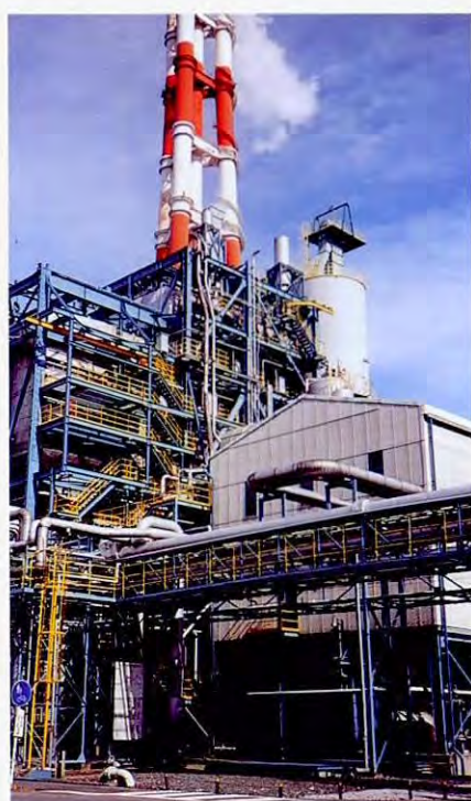
排煙脱硝装置
