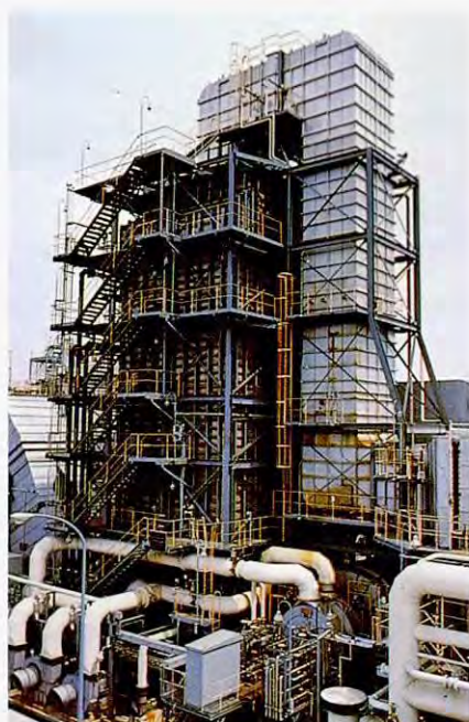
排煙脱硫装置
