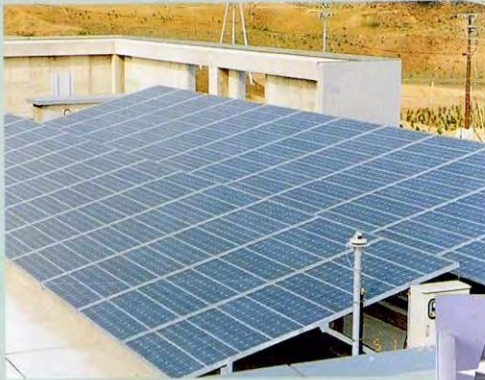
太陽光発電設備 (Photovoltaic System)
