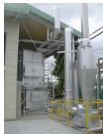
RPFボイラー
