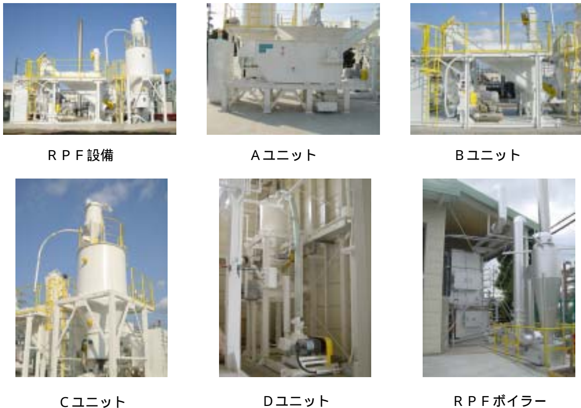
図2 RPF装置外観と各ユニット及びRPFボイラー
