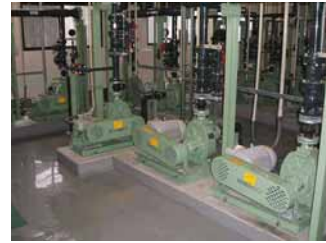
産業廃棄物処理設備汚水移送用
